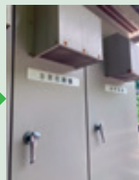
変圧後:6600ボルト
